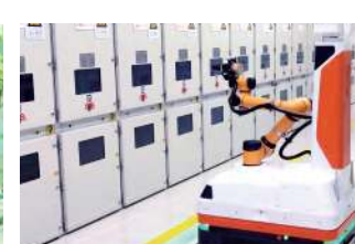
高压配电柜操作
