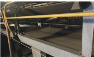
皮带输送线底部
